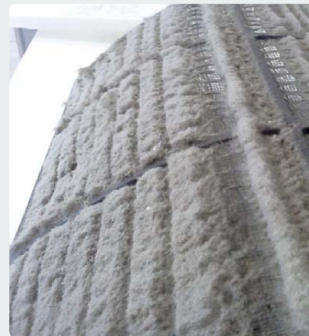
Filtro de ar de um ar-condicionado split completamente obstruído pela poeira
